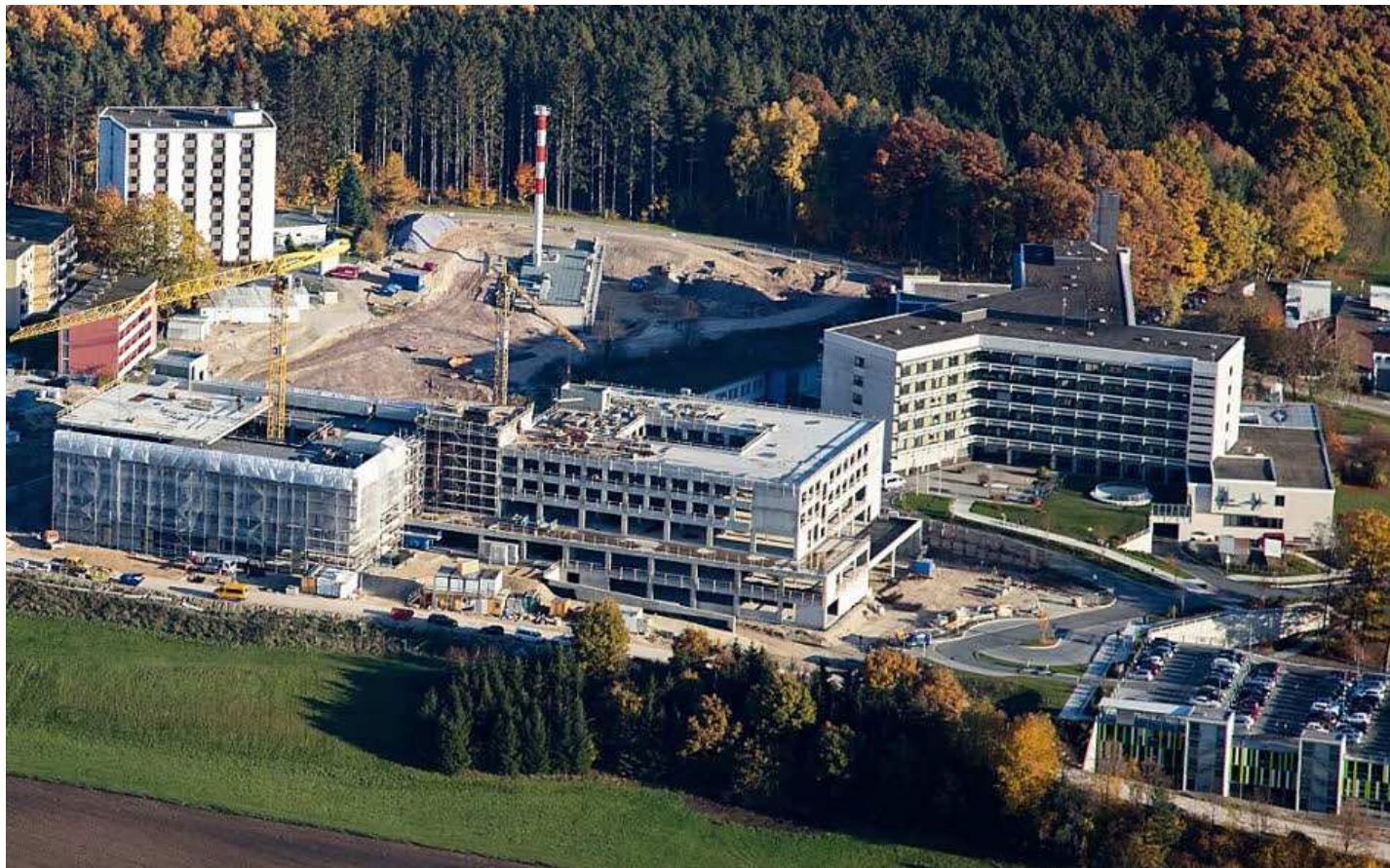
Das alte (rechts hinten) und das neue Klinikum von oben. Der Neubau wächst immer weiter in die Höhe, die Rohbauarbeiten sind nahezu abgeschlossen und nun wurde Richtfest gefeiert.
